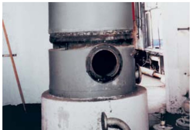
11 Asbesthaltiges Isolationsmaterial an Heizkesseln ist häufig abgedeckt, z. B. durch Blech.
