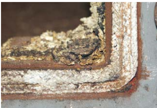
10 Vorsicht: Asbestmatten als Isolation und Asbestschnüre als Abdichtung von Türen an Feuerungsanlagen.
