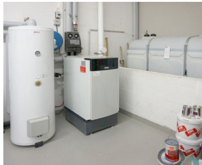
Der Ölbrennwertkessel Elco Straton 17 mit Beistellboiler und Kunststofftank für 2000 Liter Heizöl.
